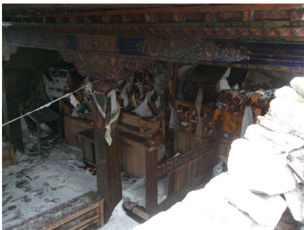
(地震、爆風で屋根、壁が崩壊した ゴンパ)
